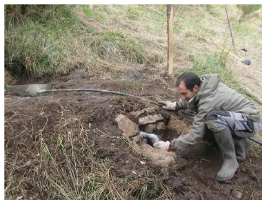
Captage de source pour l'abreuvement
